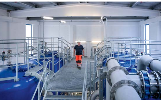
Das Wasserwerk Prießnitz ist das modernste im Gebiet des Versorgungsverbandes Grimma-Geithain.
